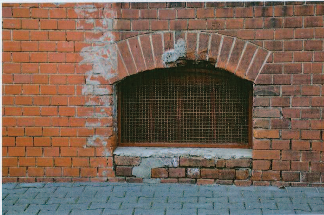
Ryc. 31. Okno piwnicy – elewacja wschodnia.
