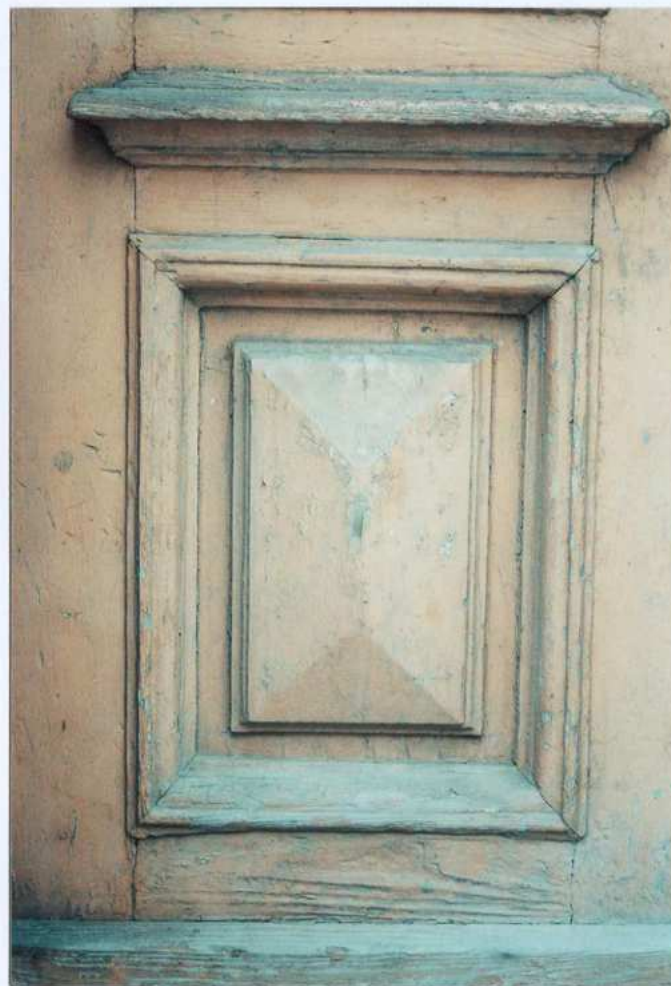
Fot. 12. Dolna część skrzydła drzwi z płyciną.
