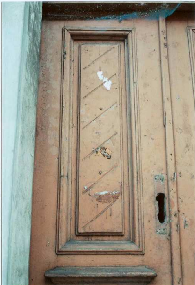
Fot. 11. Górna część skrzydła drzwi z płyciną.
