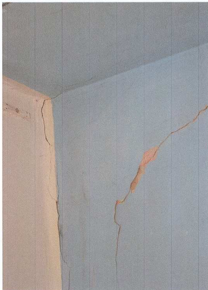
21. Spękania ścian i stropu w pomieszczeniu w środkowym trakcie, mieszkanie strona prawa
