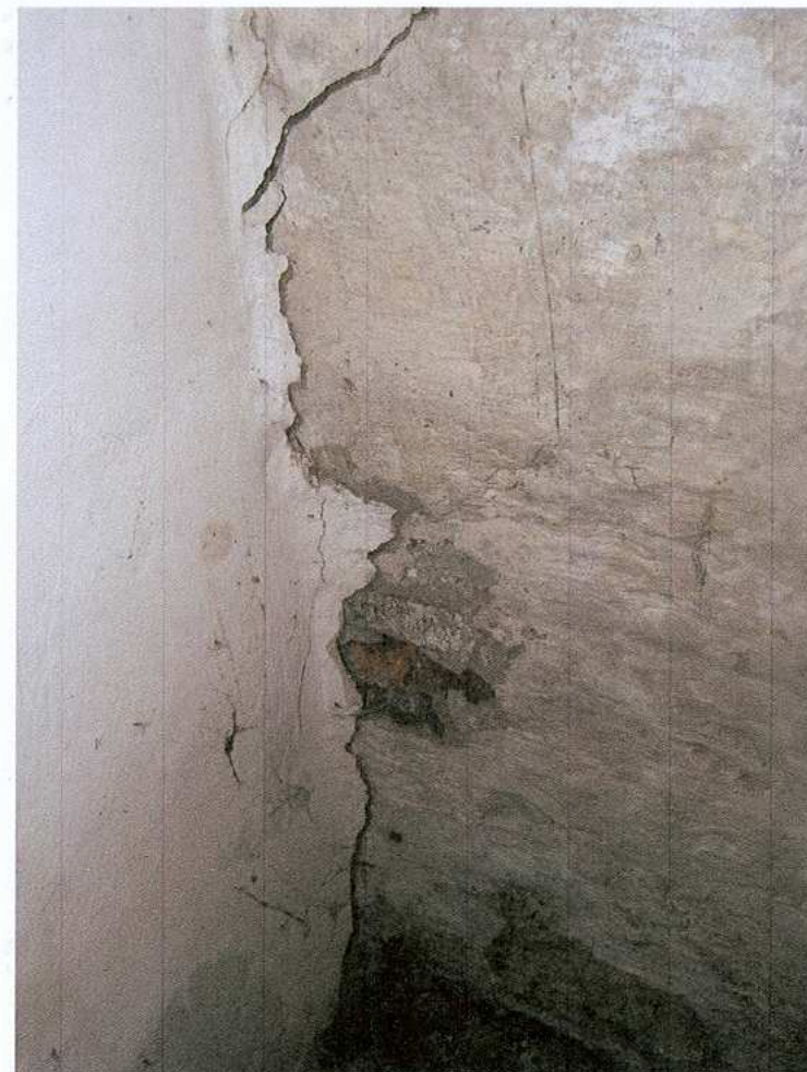
26. Spękania i uszkodzenia ścian w piwnicy
