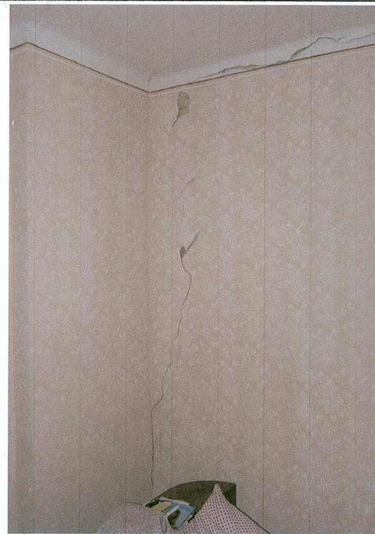
16. Spękania ścian i stropu w pomieszczeniu w południowym trakcie, mieszkanie strona lewa
