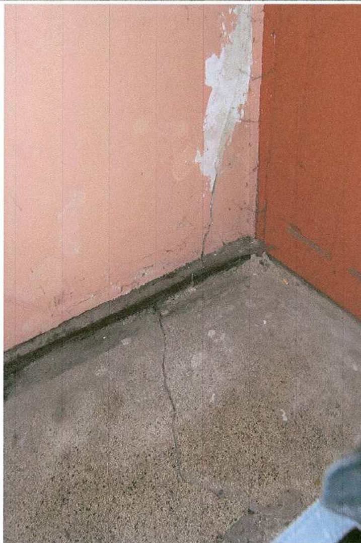
15. Pęknięcie ściany i stropu w przyziemiu
