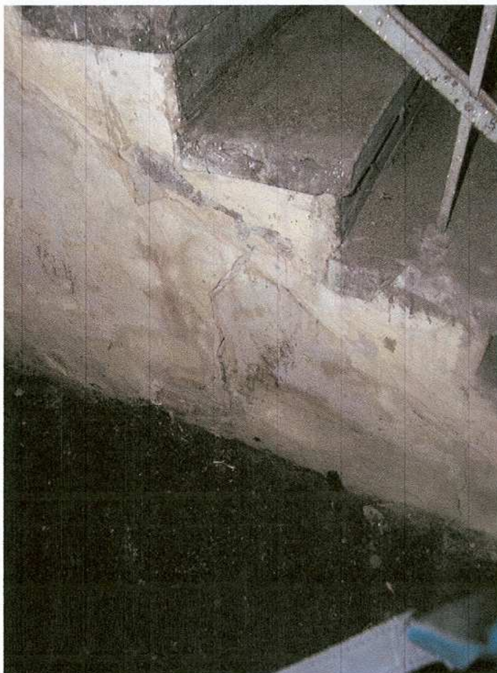
23. Uszkodzenia konstrukcji schodów w przyziemiu
