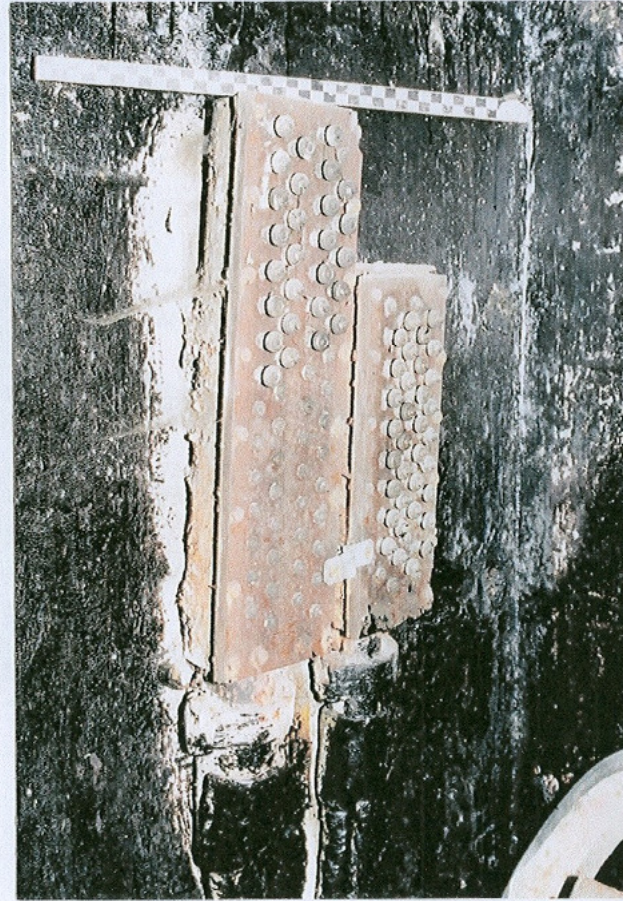
Przyłącze instalacji telefonicznej OWŚ
