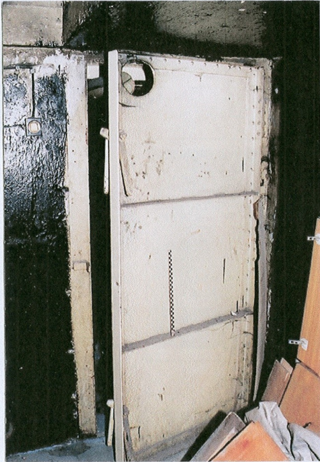
Drzwi gazoszczelne, izba łączności –b
