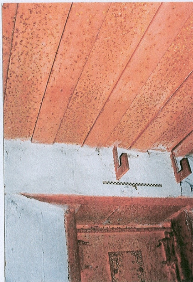
Strop z zabezpieczeniem przeciwdpryskowym
