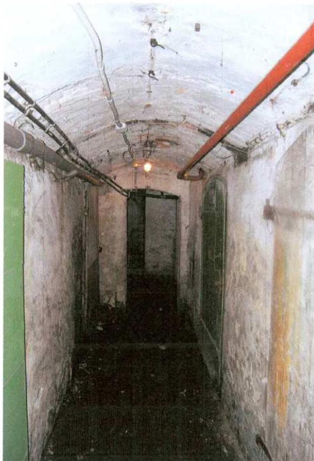
31. Korytarz piwnicy od strony ul. Niedurnego
