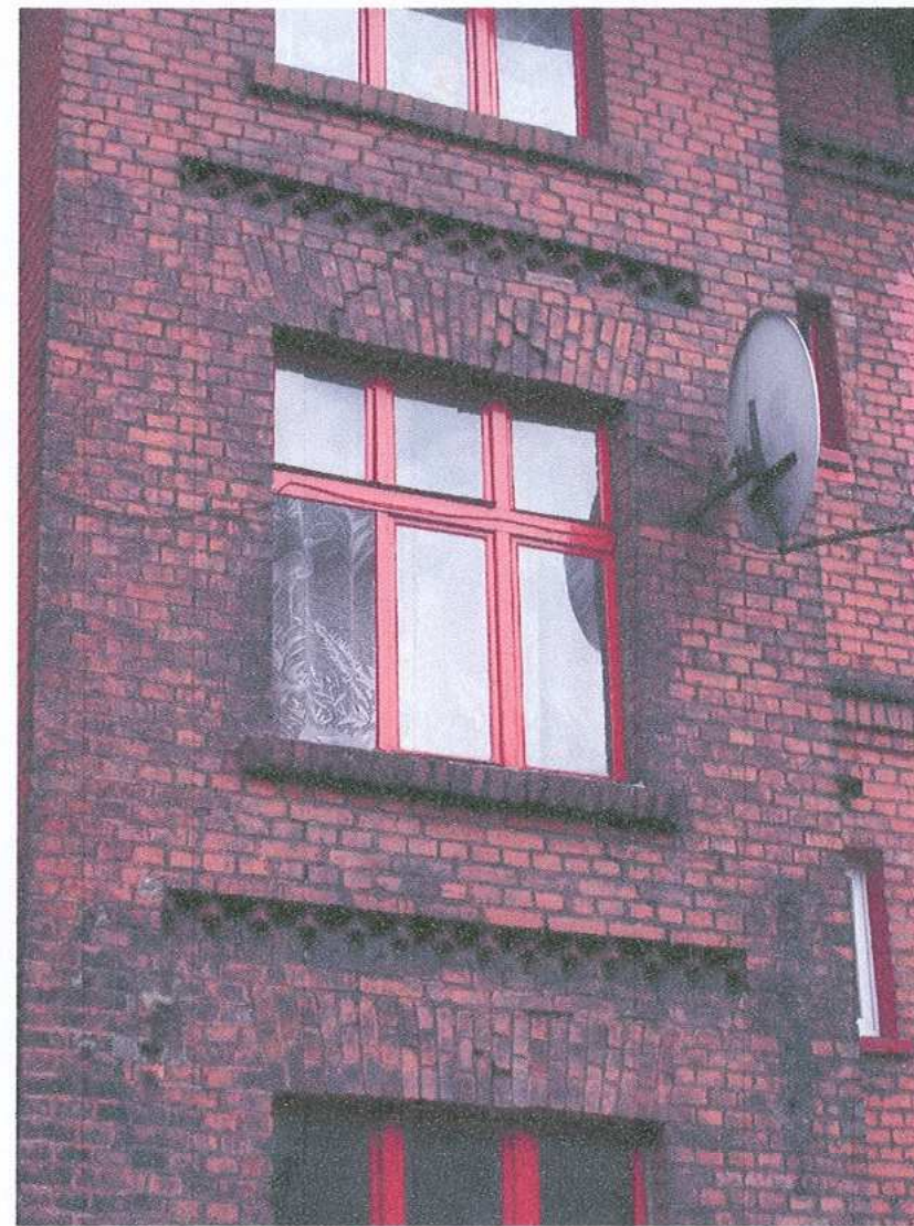
12. Spękania nadproża okna w południowym ryzalicie elewacji zachodniej
