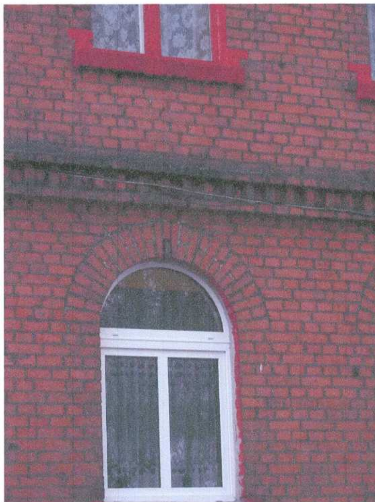
7. Spękania w części południowej elewacji wschodniej
