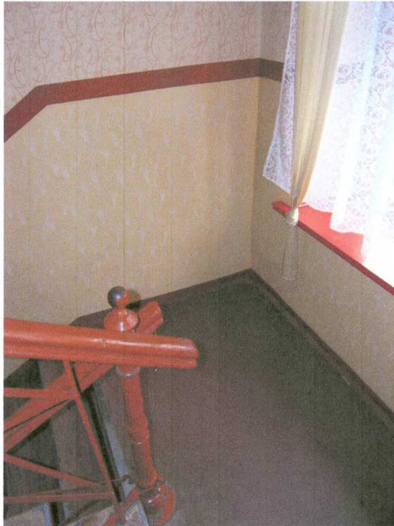
13. Słupek schodów na piętrze
