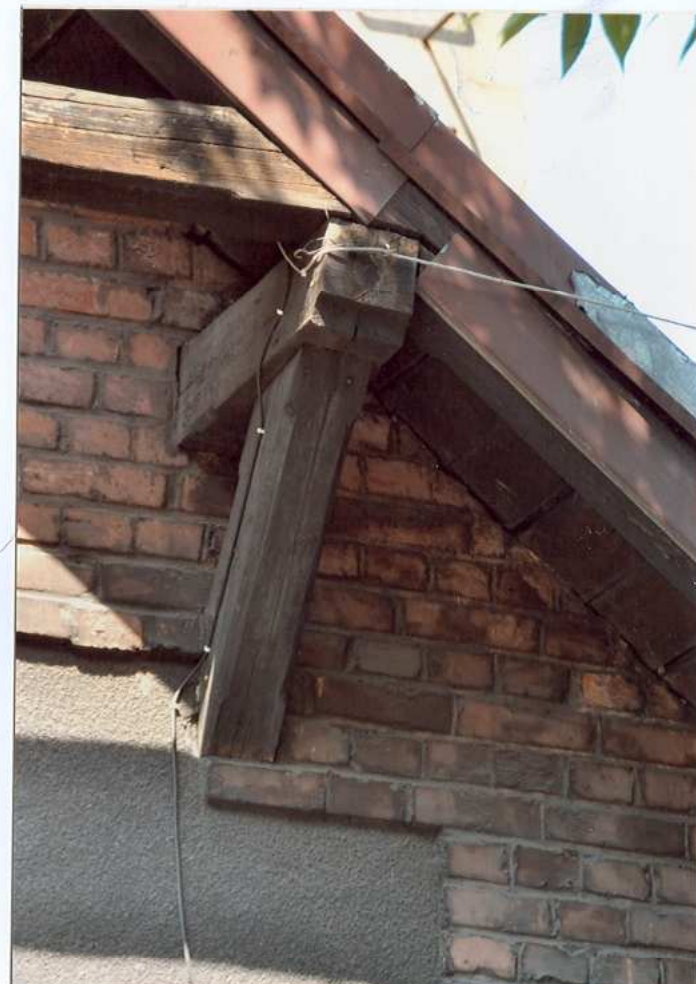
Fot. 15. Fragment więźby dachowej – rys.
