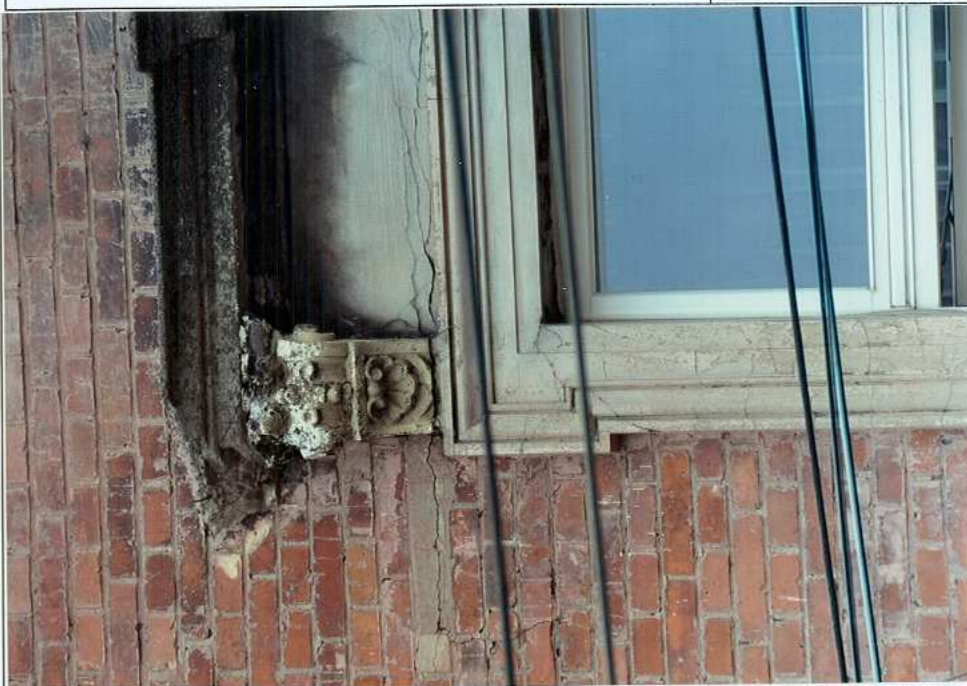
Fot. 35. Konsola – nadproże okna.
