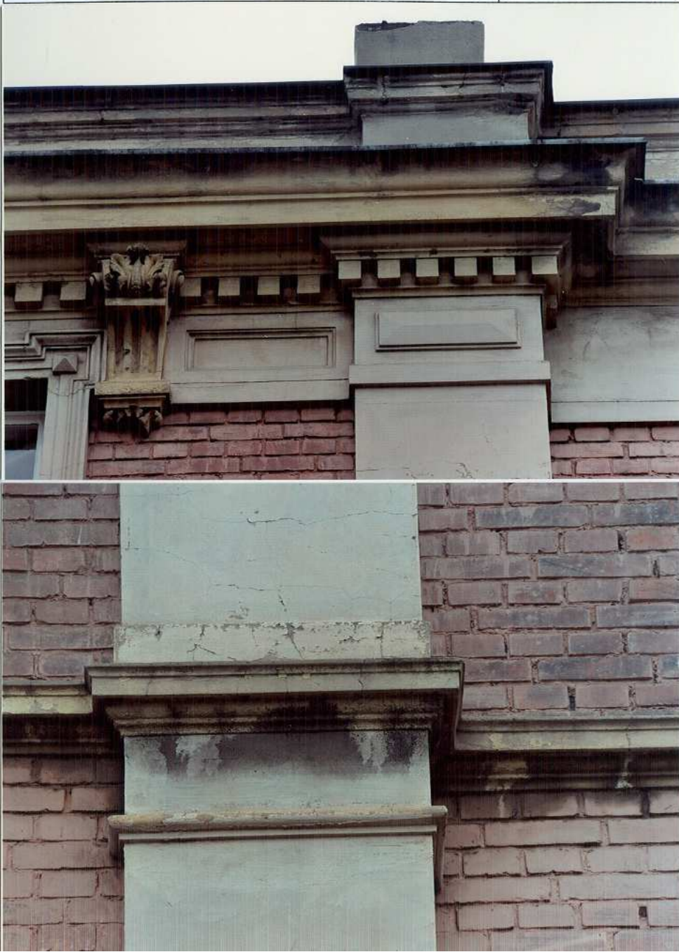
Fot. 9. Pilaster – na wysokości gzymsu międzypiętrowego Fot. 8. Górna partia pilastra – elewacja północna.
