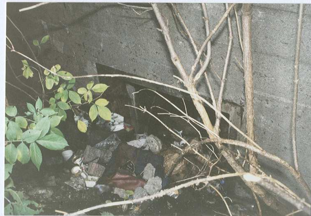
Zasypane wejście – śmietnisko !
