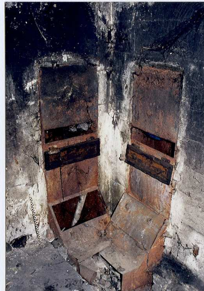
Kolektor czerpni powietrza, izba -j
