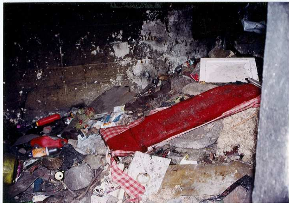
Zaśmiecenie wnętrza pomieszczenia - h
