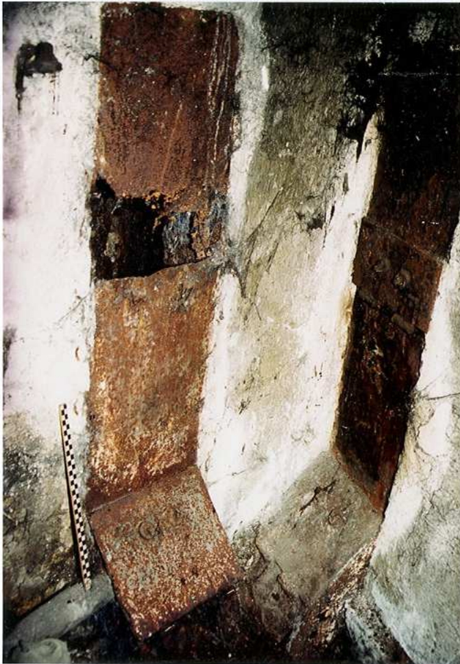
Przewody czerpni powietrza, pomieszczenie - h
