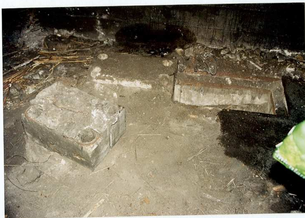
Pomieszczenie maszynowni „i”. Podstawy pod wentylator i silnik
