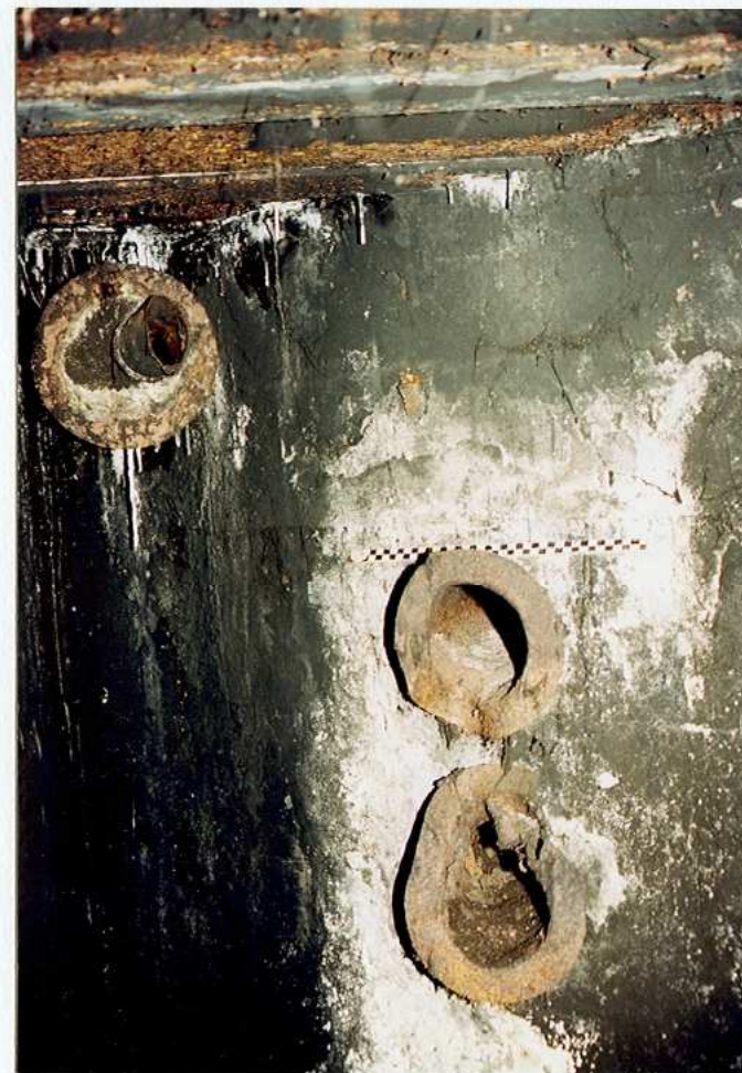
Izba bojowa „f”. Rury aparatu sygnalizacji świetlnej i wentylacyjnej
