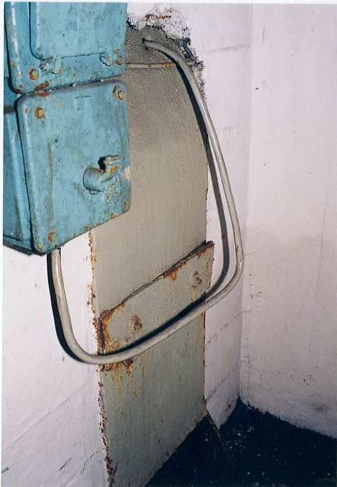
Przewody czerpni powietrza w przedsionku
