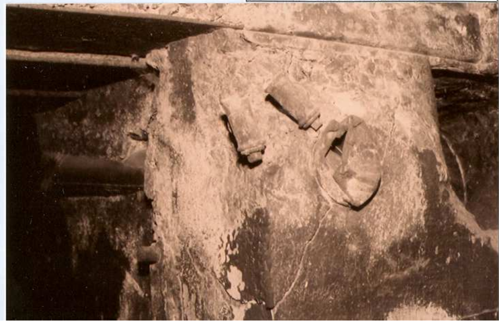
Pozostałości instalacji chłodzenia ckm
