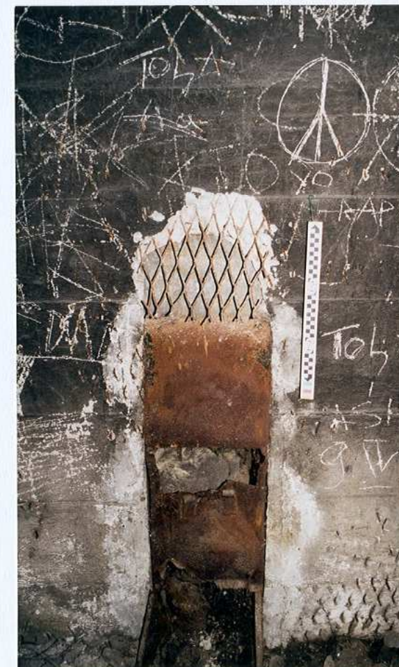
Wlot kanału wentylacyjnego
