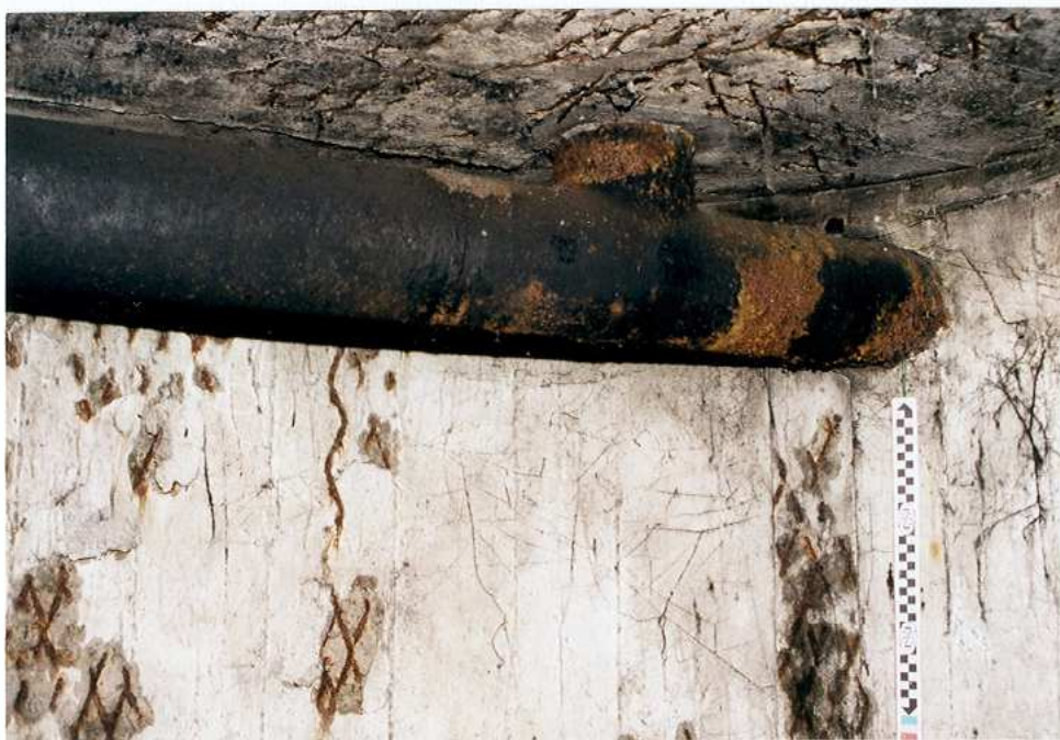
Rura instalacji wentylacyjnej w szybie kopuły -g
