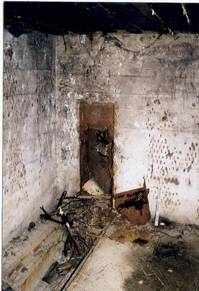
Maszynownia. Kanaly wentylacyjne
