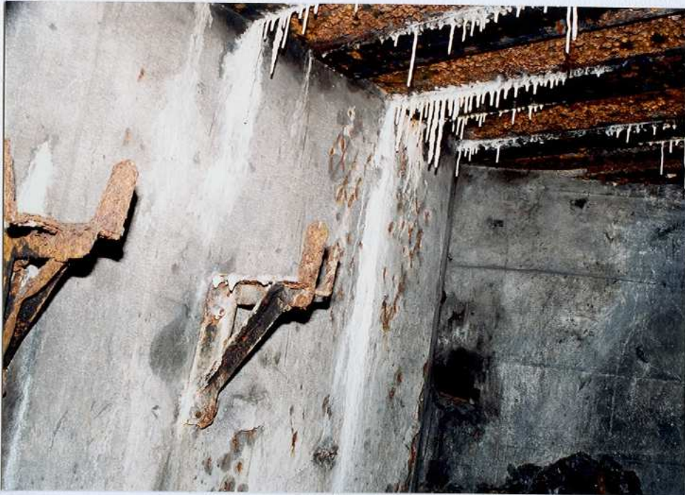
Łącznik -K. Osady spowodowane nieszczelnością stropu
