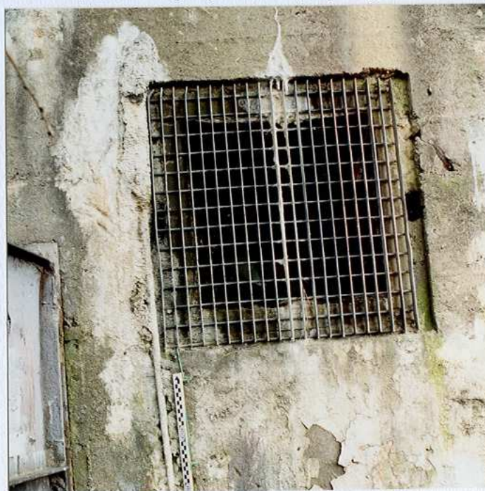
Otwór czerpni powietrza przy wejściu
