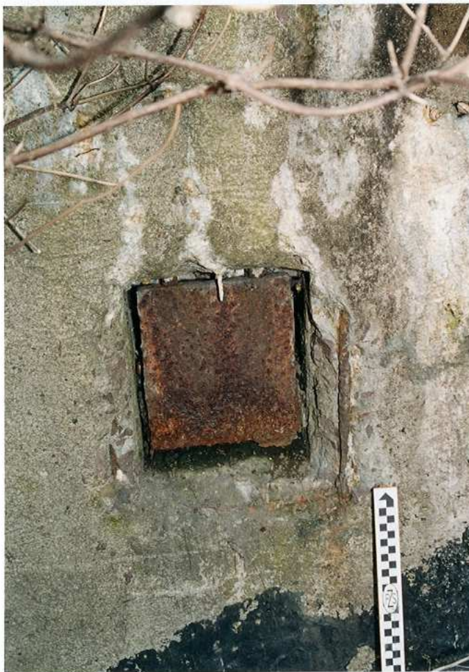
Pancerz wylotu powietrza instalacji went
