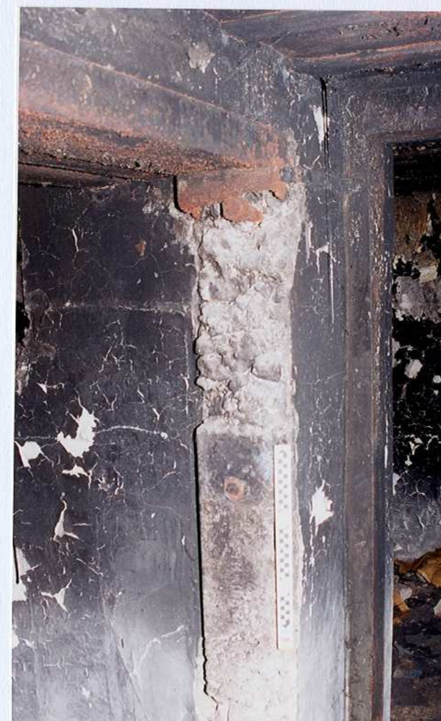
Futryna drzwi śluzy gazowej - kradzież
