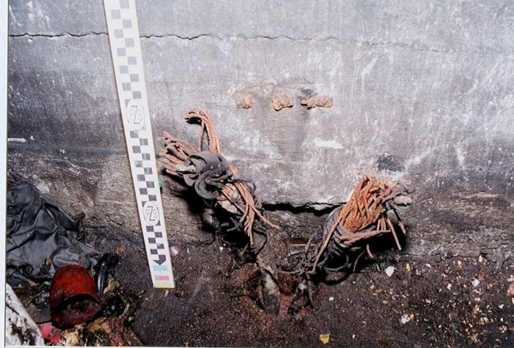
Izba dowodzenia – h, wyjście kabli instalacji telefonicznej SOW
