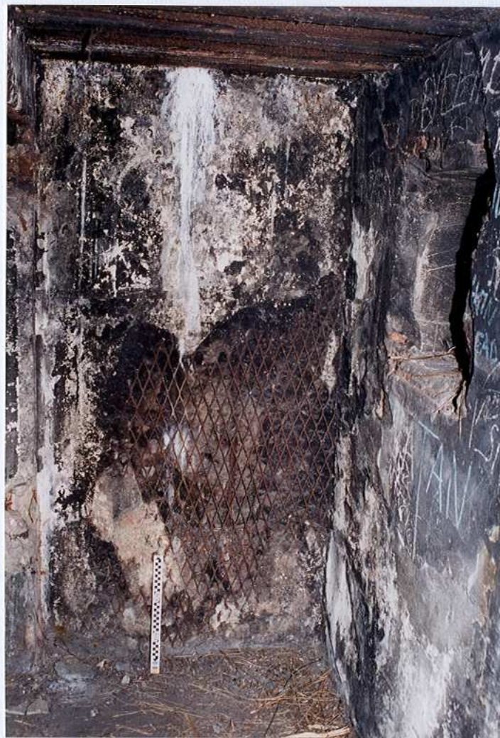
Siatka przeciwdpryskowa odsłonięta w partii przedsionka-a
