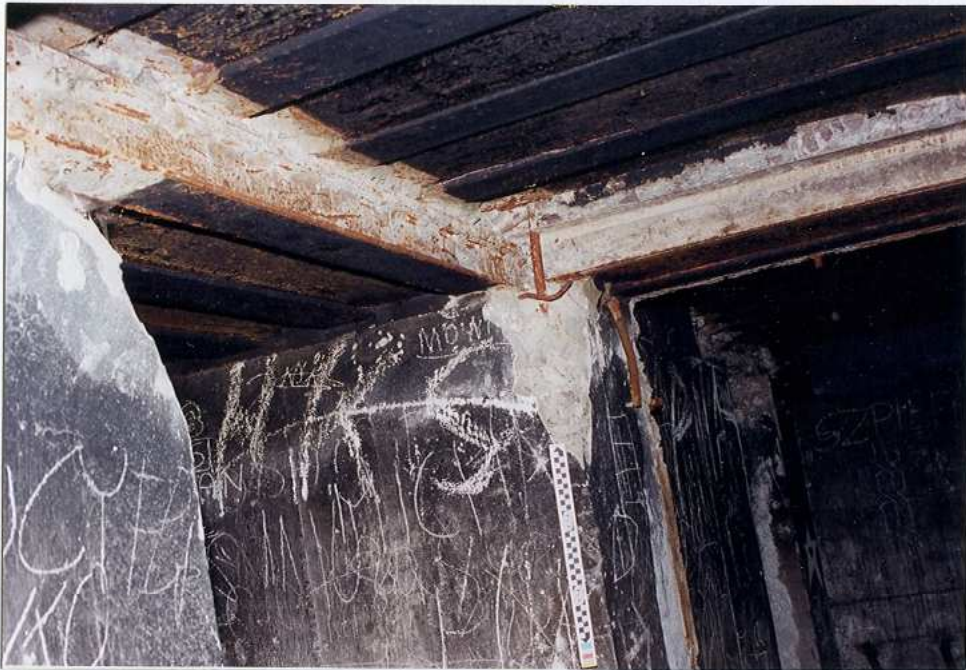
Strop w partii komory amunicyjnej, ślady kradzieży
