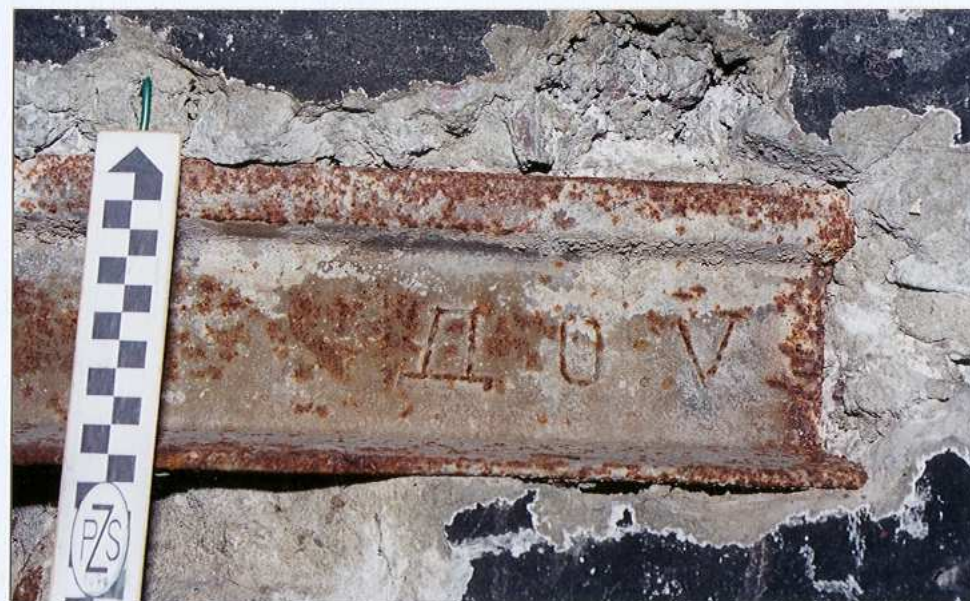
Rosyjska szyna kolejowa w roli wzmocnienia nadproża - odkucie przygotowane do kradzieży!
