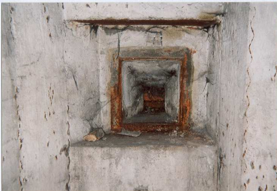
Pomieszczenie maszynowni „b”. Strzelnica rkm.
