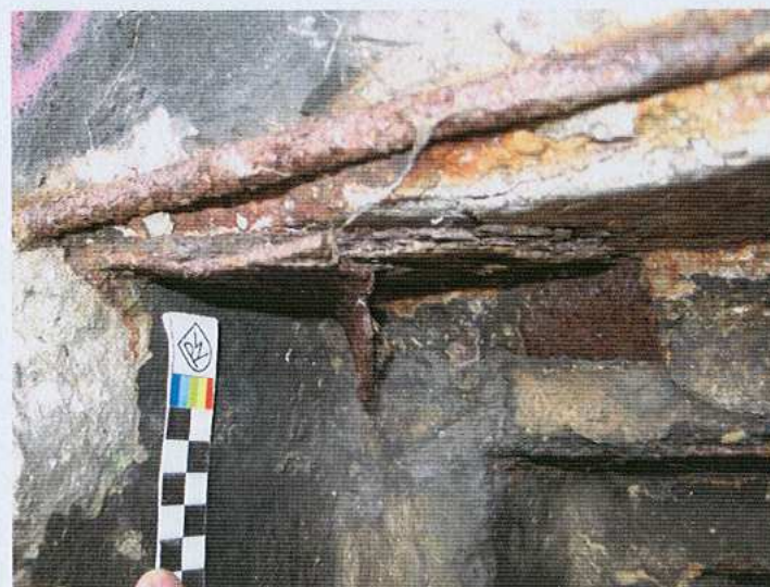
Zniszczenia korozyjne w obrębie strzelnic
