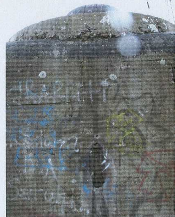
Nieszczelności izolacji zewnętrznej stropu
