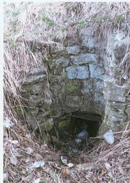
Uszkodzona studnia wentylacji
