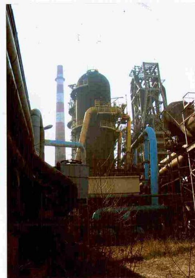
Widok nagrzewnicy nr 3 od strony północnej
