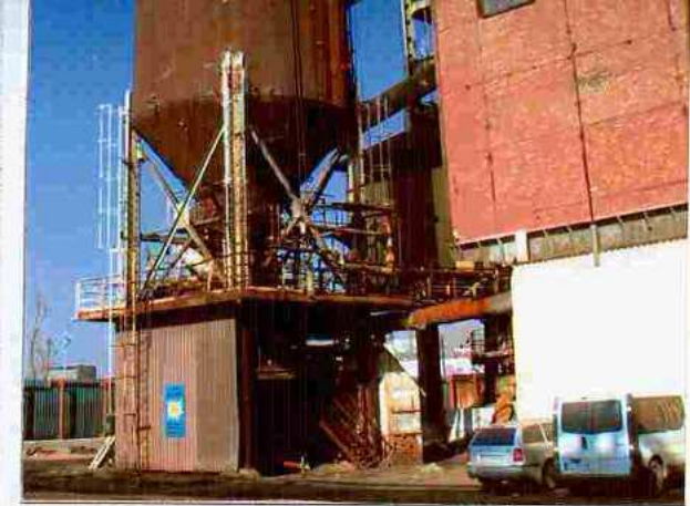
Widok odpylnika statycznego od strony południowego - wschodu
