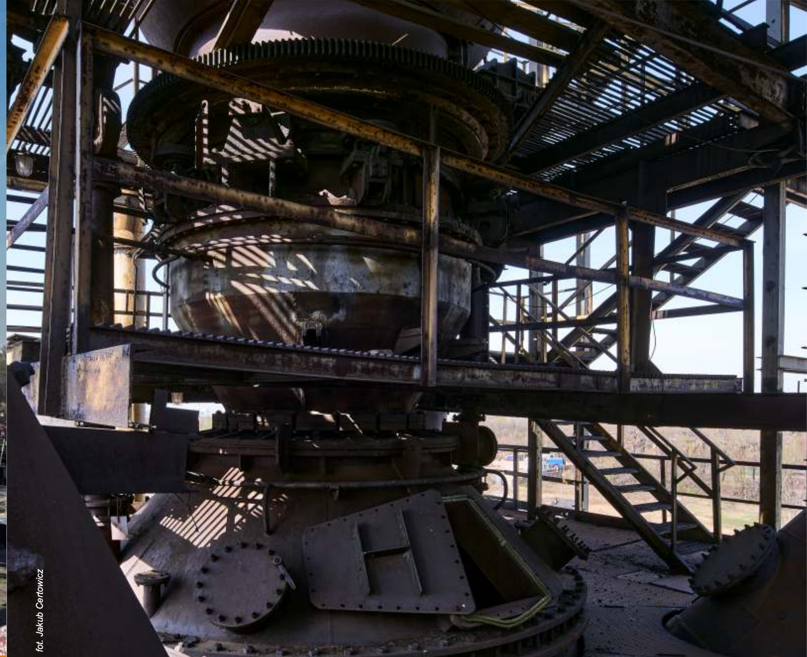
Aparat zasypowy Wielkiego Pieca. Blast furnace charging apparatus.
